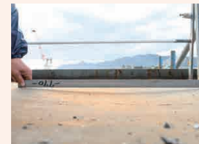
定規の下空洞になっている部分が「歪み」
